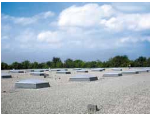
Die Kiesauflast sorgt unter anderem für eine zuverlässige Windsogbeschwerung und verzögert bzw. reduziert die abzuführenden Regenwassermengen.
