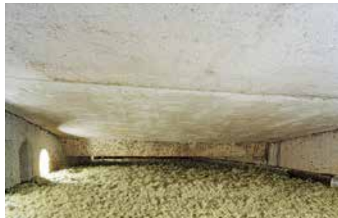
Mit Fillrock RG gedämmtes belüftetes Flachdach
